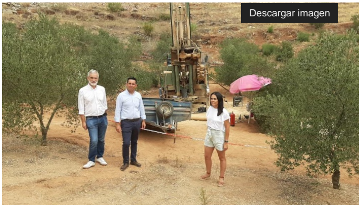
Gonzalo Domínguez con la alcaldesa de Guadalcanal en la visita a las obras hidráulicas en el municipio
