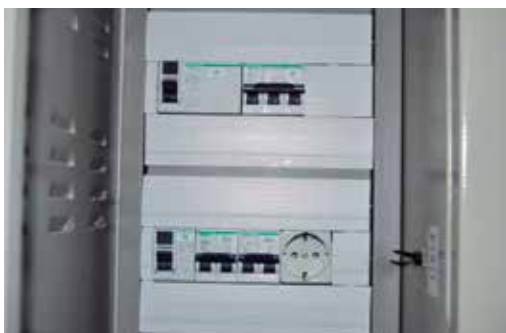
▼ V.E. 22. Interruptor magnetotérmico alumbrado hueco y conmutador de encendido
