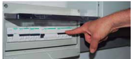
▼ V.C. 4. Desconexión I. Diferencial cto. fuerza. ▼ V.C. 5. Desconexión I. Magnetotérmico cto. fuerza.
