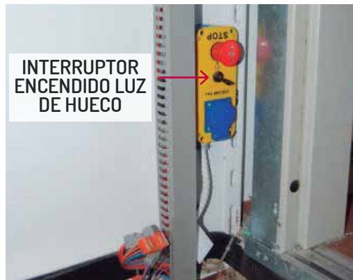
▼ V.C. 7. Interruptor encendido luz de hueco.
