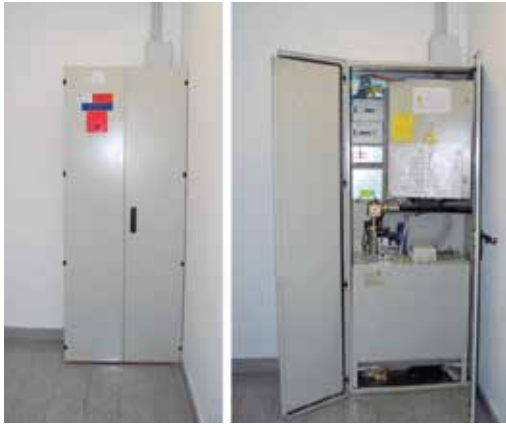
▼ V.E. 27 y 28. Armario de maniobra ascensor hidráulico.
