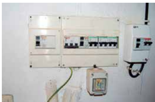
▼ V.E. 26. Interruptor magnetotérmico desconectado.
