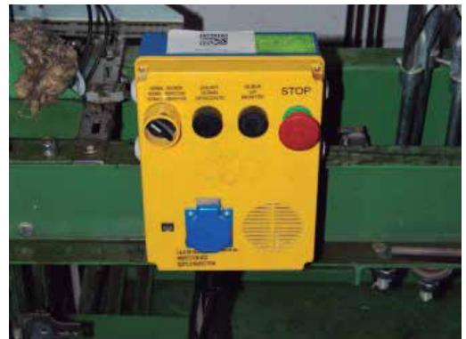
👉 V.E. 55. Botonera de inspección en techo de cabina
