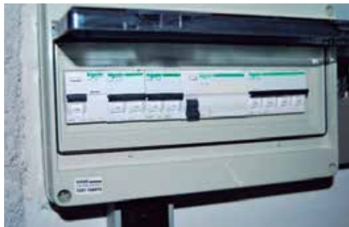
▼ V.E. 25. Interruptor diferencial desconectado.
