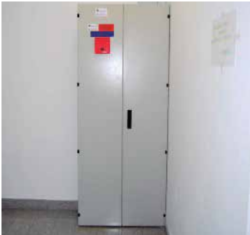
▼ V.C. 1. Armario de maniobra de ascensor hidráulico
