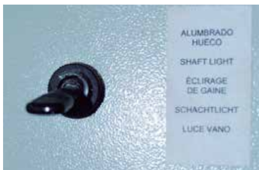
▼ V.E. 21. Interruptor alumbrado de hueco en lateral
