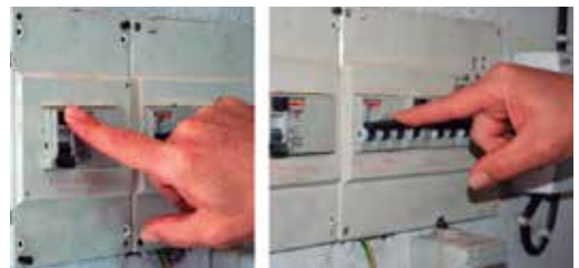
▼ V.E. 26. Interruptor magnetotérmico desconectado.
