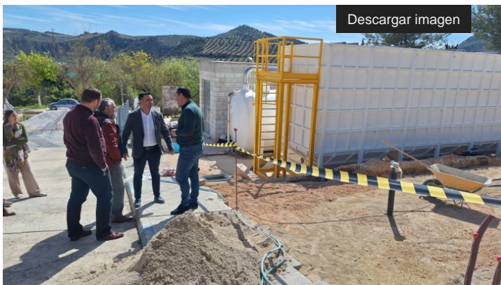
Gonzalo Domínguez y el alcalde de Badolatosa visitan la ETAP objeto de las obras de emergencia para su mejora
